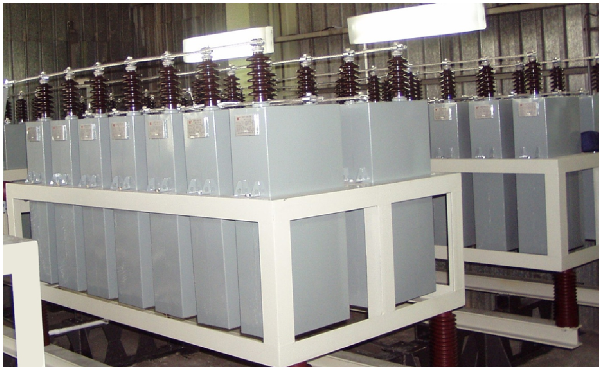
Bateria kondensatorów z dławikami rezonansowymi w układzie filtra 4-tej harmonicznej o mocy rzeczywistej 20MVar/31,5kV. Realizacja Elma energia
