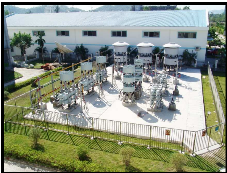
Instalacja SVC wykonana przez firmę RPXE
