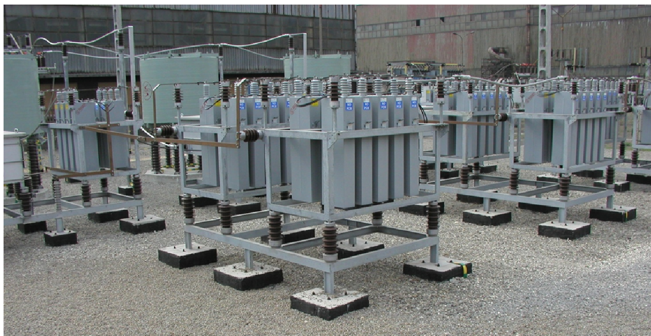
Filtr 2-giej harmonicznej typu „C” na napięciu 38,5kV. Realizacja Elma energia
