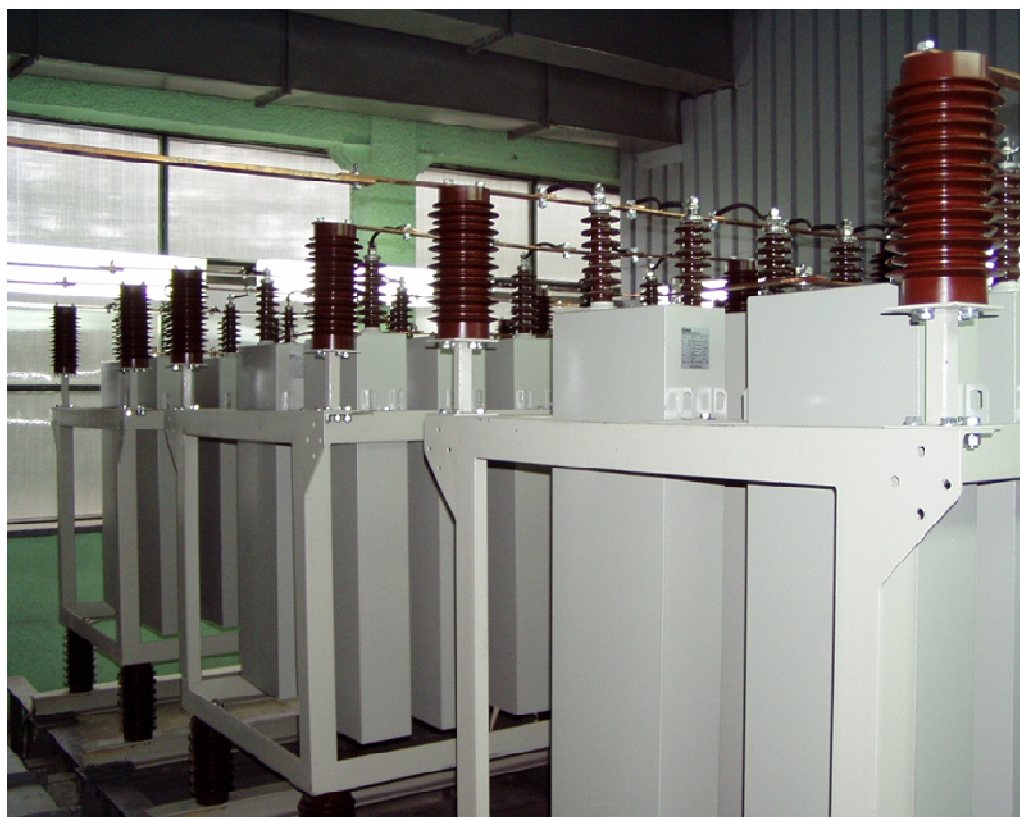
Bateria kondensatorów z dławikami rezonansowymi w układzie filtra 3-ciej harmonicznej 31,5kV. Realizacja Elma energia
