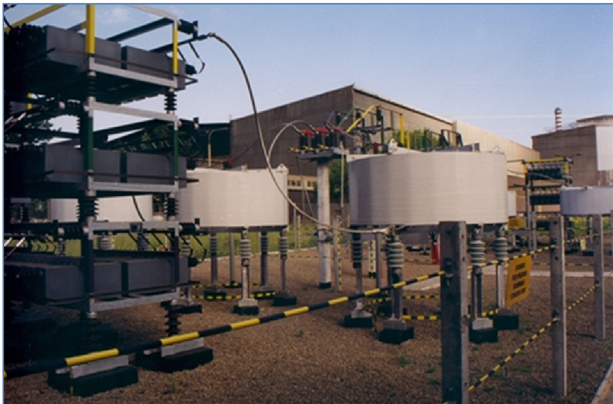
Automatycznie regulowana bateria kondensatorów 70MVar/42kV w układzie filtra 3-ciej harmonicznej. Realizacja Elma energia
