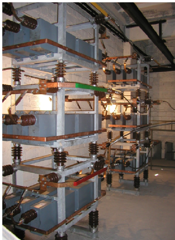
Nizhny Tagil- Rosja Bateria kondensatorów z dławikami rezonansowymi w układzie filtra 3-ciej harmonicznej. Realizacja Elma energia
