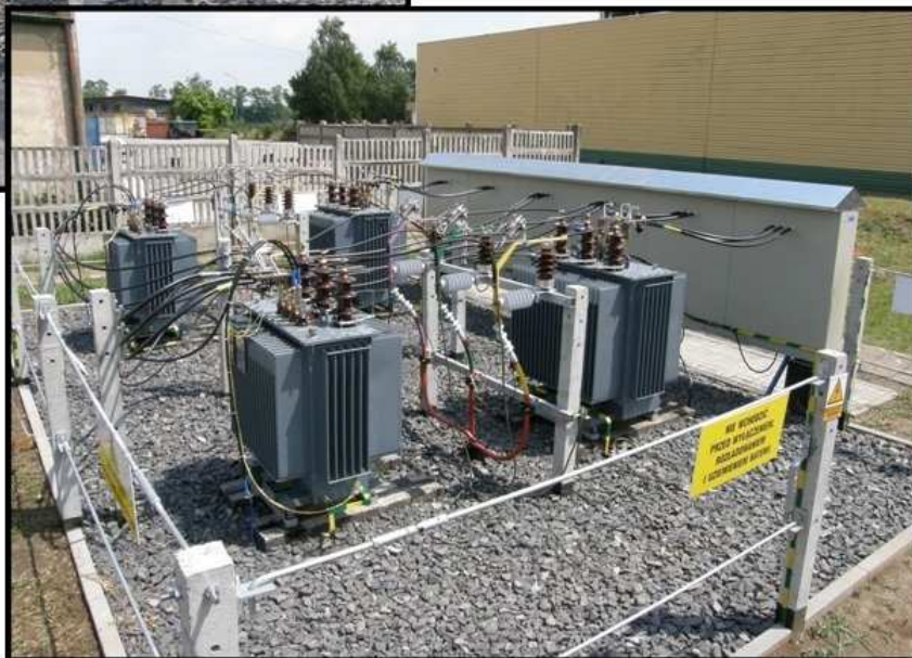
Transformatorowe filtry pasywne LC. Instalacja na napięciu 21,4kV. Realizacja Elma energia
